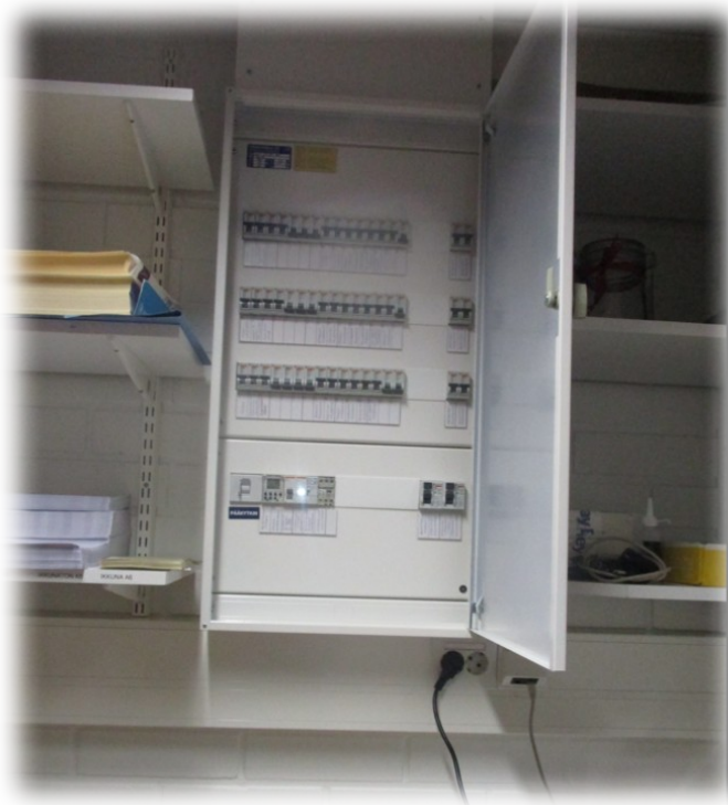
Kuva 8. Sulaketaulu viraston kopiointihuoneessa.
