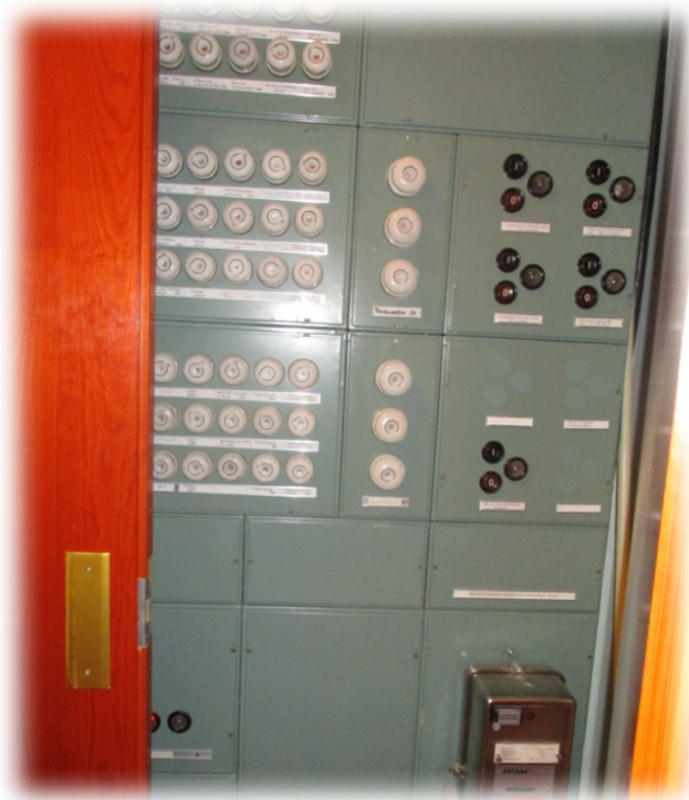
Kuva10. Sähkökeskus on keittiöstä ulos menevän käytävän varressa.
