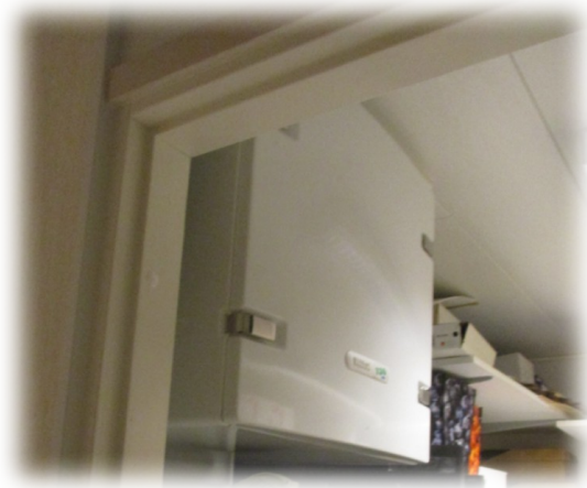
Kuva 2. Viraston ilmastointikone on jaetun työhuoneen varastossa.
