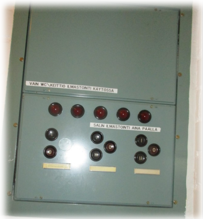
Kuva11. Wc-tilojen ilmastointien säätö
