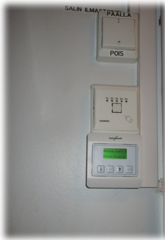
Kuva 9. Salin ilmastoinnin säätö keittiöstä ulosmenevän käytävän varressa.
