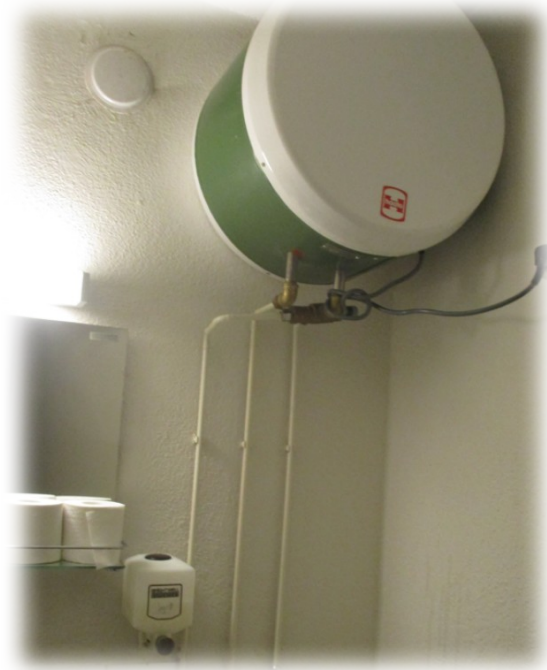
Kuva 13. Lämminvesiboileri sakastin wc:ssä.
