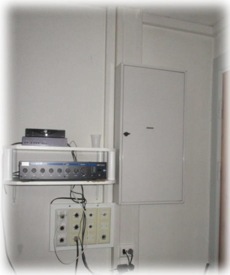
Kuva11. Sakastin ja varaulostien käytävällä sulaketäulu - ja äänentoistolaitteiden ohjaus
