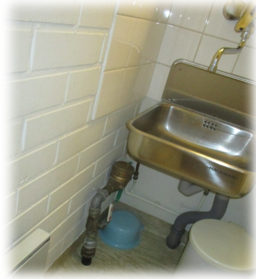
Kuva 12. Käyttöveden pääsulku sakastin wc:ssä.
