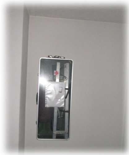
Kuva 6. Ensiapuvälineet pääoven tuulikaapissa
