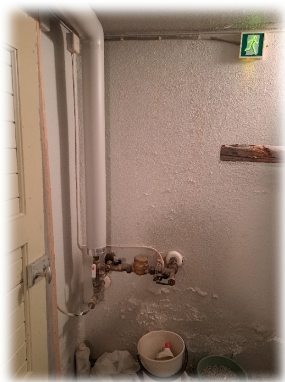
Kuva 8. Turvaopaste kellarissa ja päävedenkatkaisu
