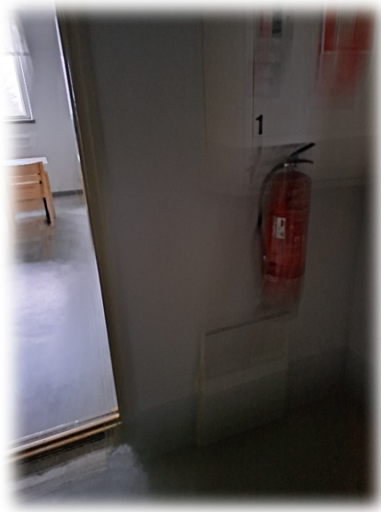
Kuva 9. Jauhesammutin ja paloletku seurakuntasalin eteisessä
